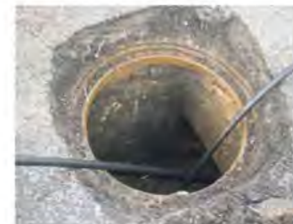
Il cavo entra nel torrino fognario
