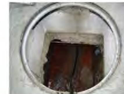
Il cavo nel condotto fognario
