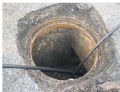
Il cavo entra nel torrino fognario
