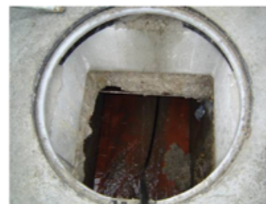
Il cavo nel condotto fognario
