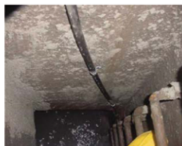
Il cavo è fissato solo lungo la parete d'ingresso
